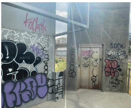
Anexo 1 – Elevador encerrado e paredes vandalizadas
